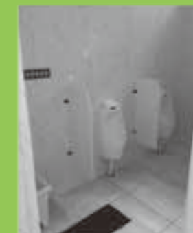
水洗トイレ内部の様子
