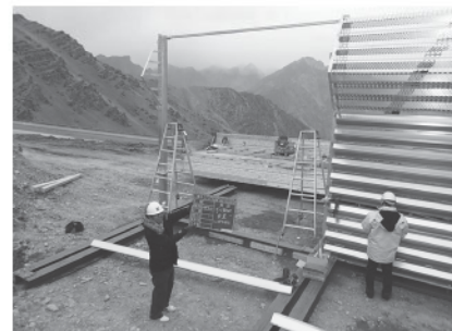
キルギス ビシュケク-オシュ道路 Too-Ashuu峠での防雪柵試験施工時の状況
