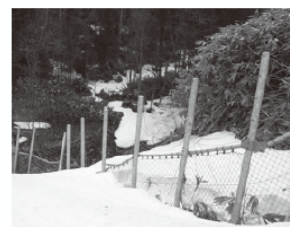
【写真1】 斜面部の雪圧による破損
