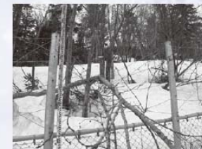
【写真3】 倒木による柵破損箇所
