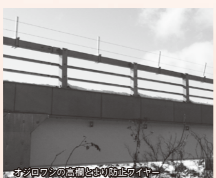
オジロワシの高欄とまり防止ワイヤー
