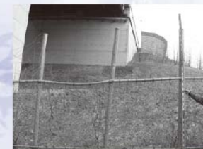
【写真2】橋梁下での柵破損箇所
