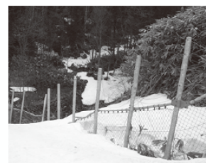
【写真1】斜面部の雪圧による破損
