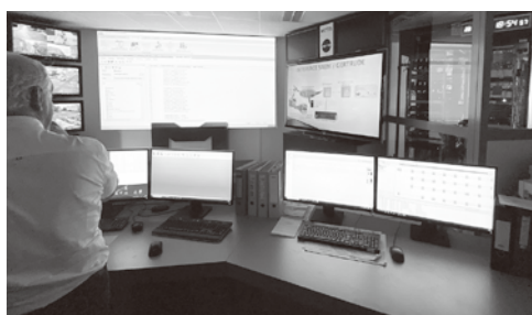
【交通管制室】 左側の複数のモニターで市内の主要交差点を常時モニタリングしており、渋滞発生時などには必要に応じてサイクル長を変えるなど、この場所から信号制御を行っている。交通状況は、右奥のサーバーに蓄積されているとのこと。
